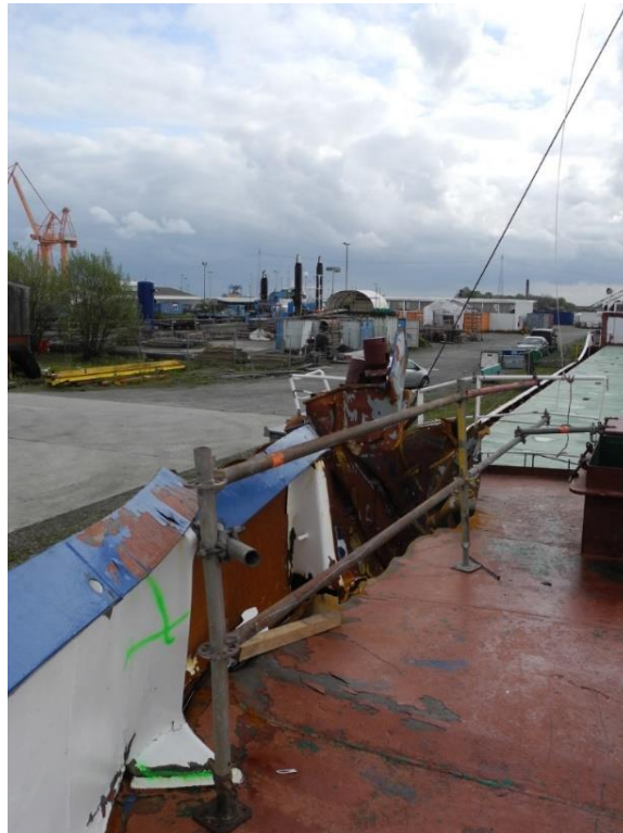
Abbildung 5: Back mit Blick auf Schaden 6
